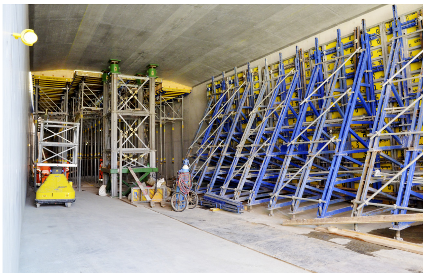
Bau der neuen (Bieler-) Unterführung: Im Dezember 2019 werden die RBS-Züge doppelspurig unter dem SBB-Trasse Richtung Biel fahren (im Sommer 2019 bereits einspurig).
