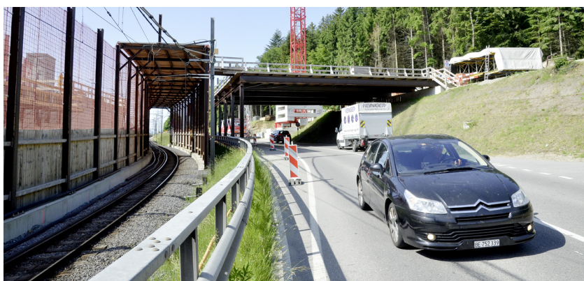
Damit der Kran gefahrlos Material über Schiene und Strasse zur Baustelle hieven kann, sind Schutztunnels über beide Verkehrsträger erforderlich.
