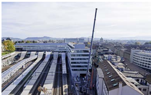
Der hohe Mobilkran war von weitem zu sehen und diente dazu, den fixen Kran bei der Baustelle zu errichten.
