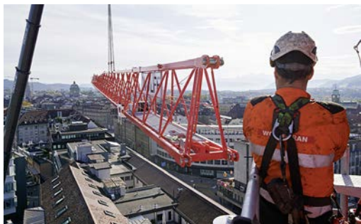
Die einzelnen Elemente des Krans wurden vom Mobilkran in luftige Höhen hochgehoben.
