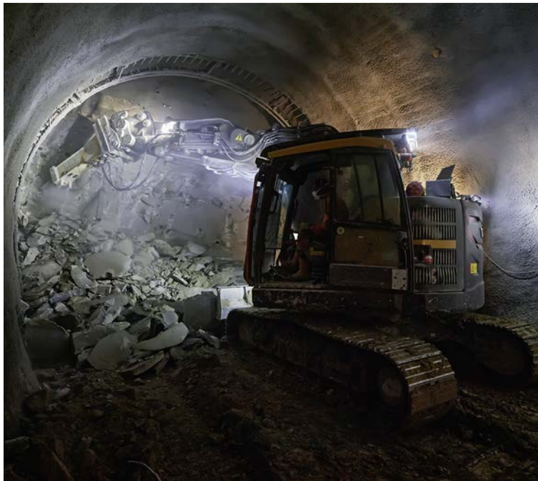
Der Stollen, welcher für den Bau mit dem speziellen Gefrierverfahren stabilisiert worden ist.
